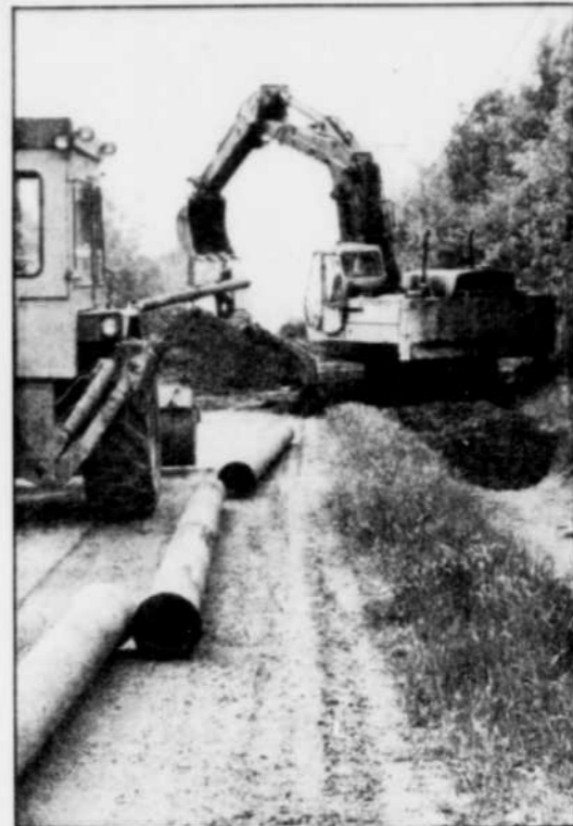
Les travaux pour raccorder le secteur de Sainte-Gertrude, le seul qui ne l'était pas, au réseau municipal d'aqueduc de la ville de Bécancour, ont débuté et vont bon train. On sait que ces travaux sont réalisés grâce à une subvention fédérale de l'ordre de $421,000. (Photo J. Côté)
