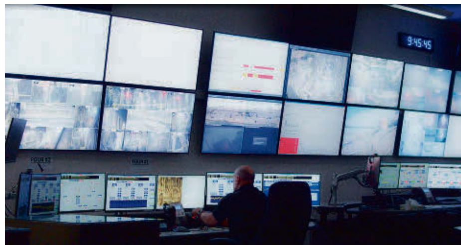
La salle de contrôle centralisée des Opérations primaires est munie d'équipements à la fine pointe de la technologie. Photo gracieuseté
