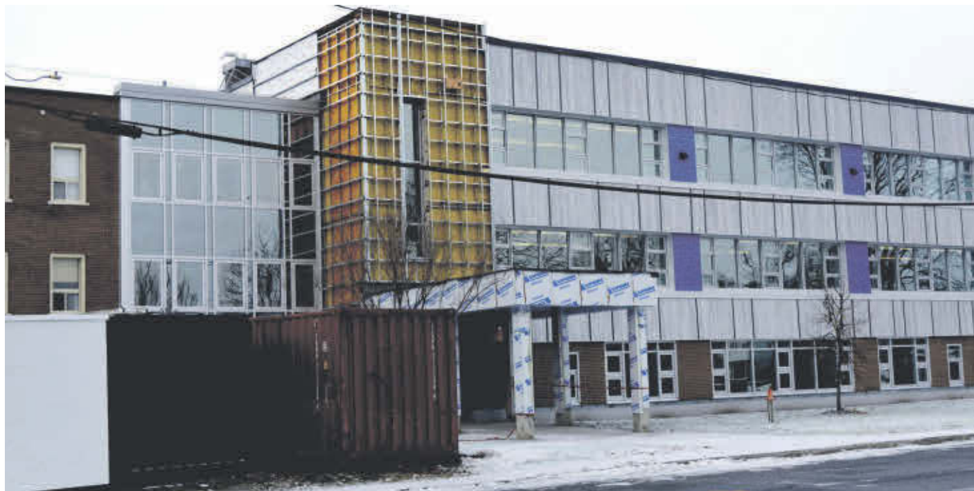
Un important chantier est en cours à l'école Saint-André d'Acton Vale, pour un montant d'environ 2,3 millions $.
