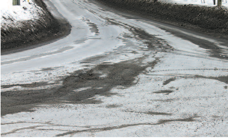
Le chemin Sainte-Anne-des-Lacs est dans un mauvais état
