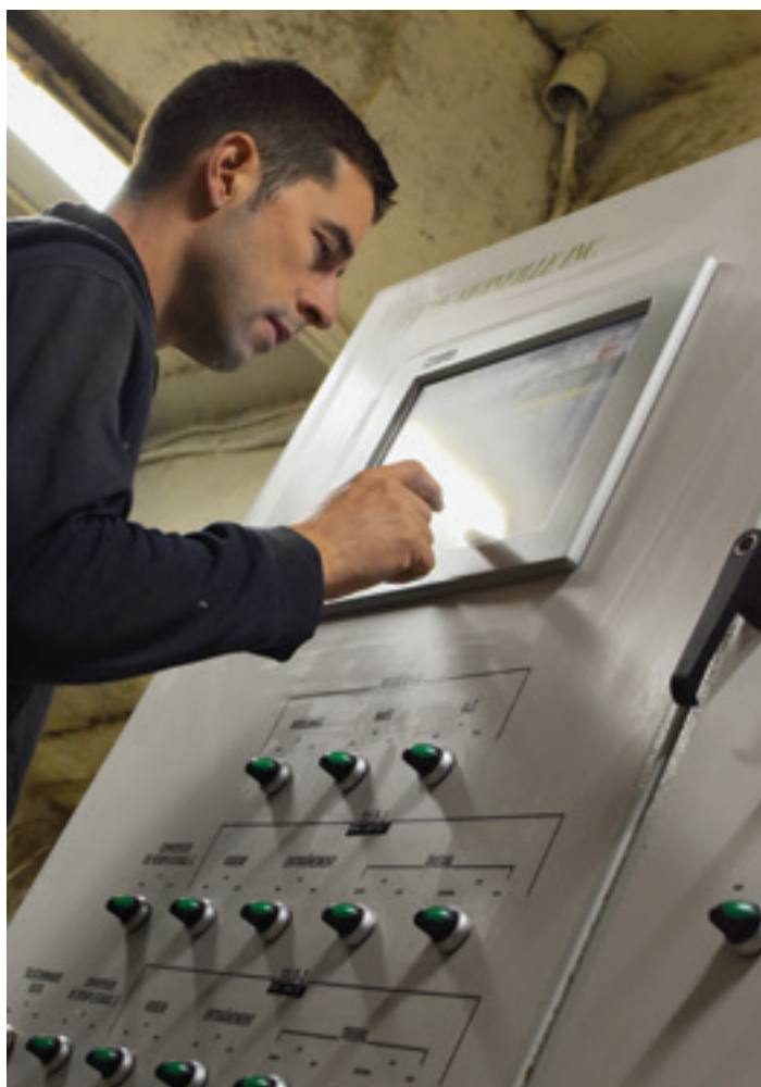
Alexandre Veilleux a investi récemment dans un panneau de contrôle du système d'alimentation. Il estime ainsi gagner environ une heure de travail par jour.
