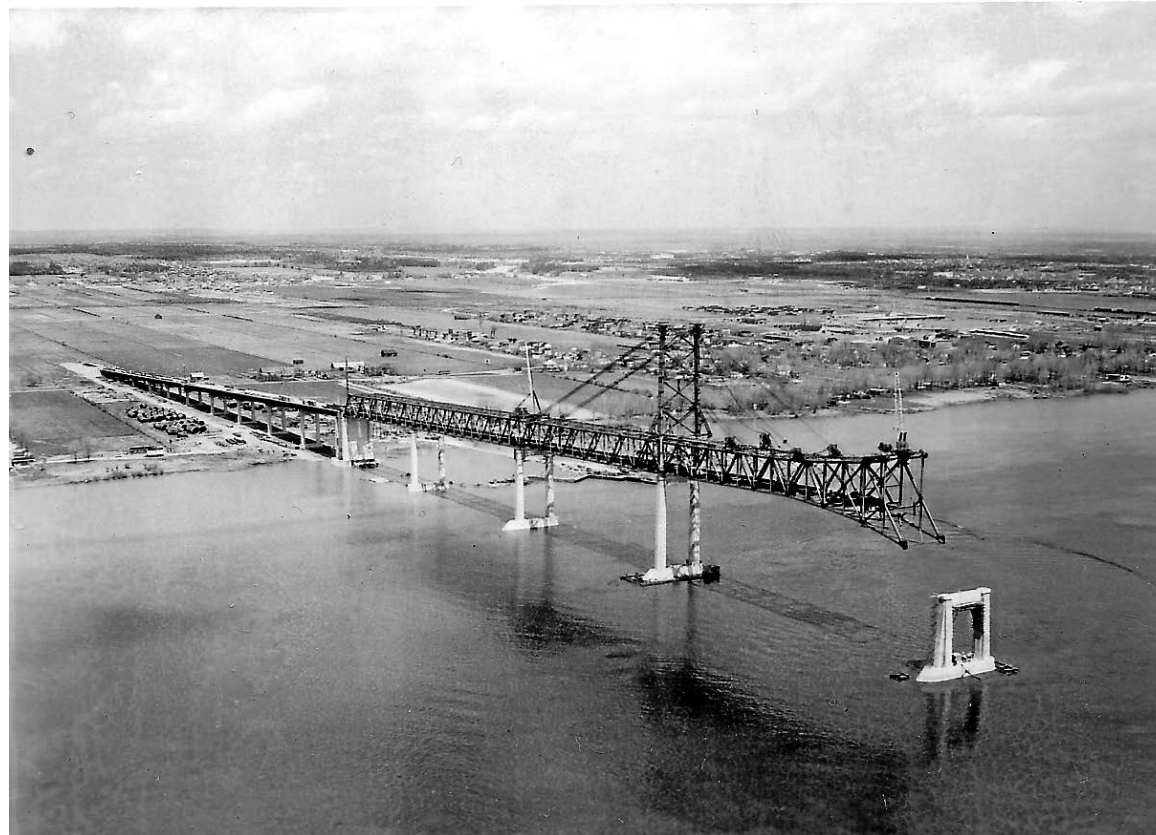
La construction du pont Laviolette s'est échelonnée sur trois années et demie. — PHOTO: APPARTENANCE MAURICIE
