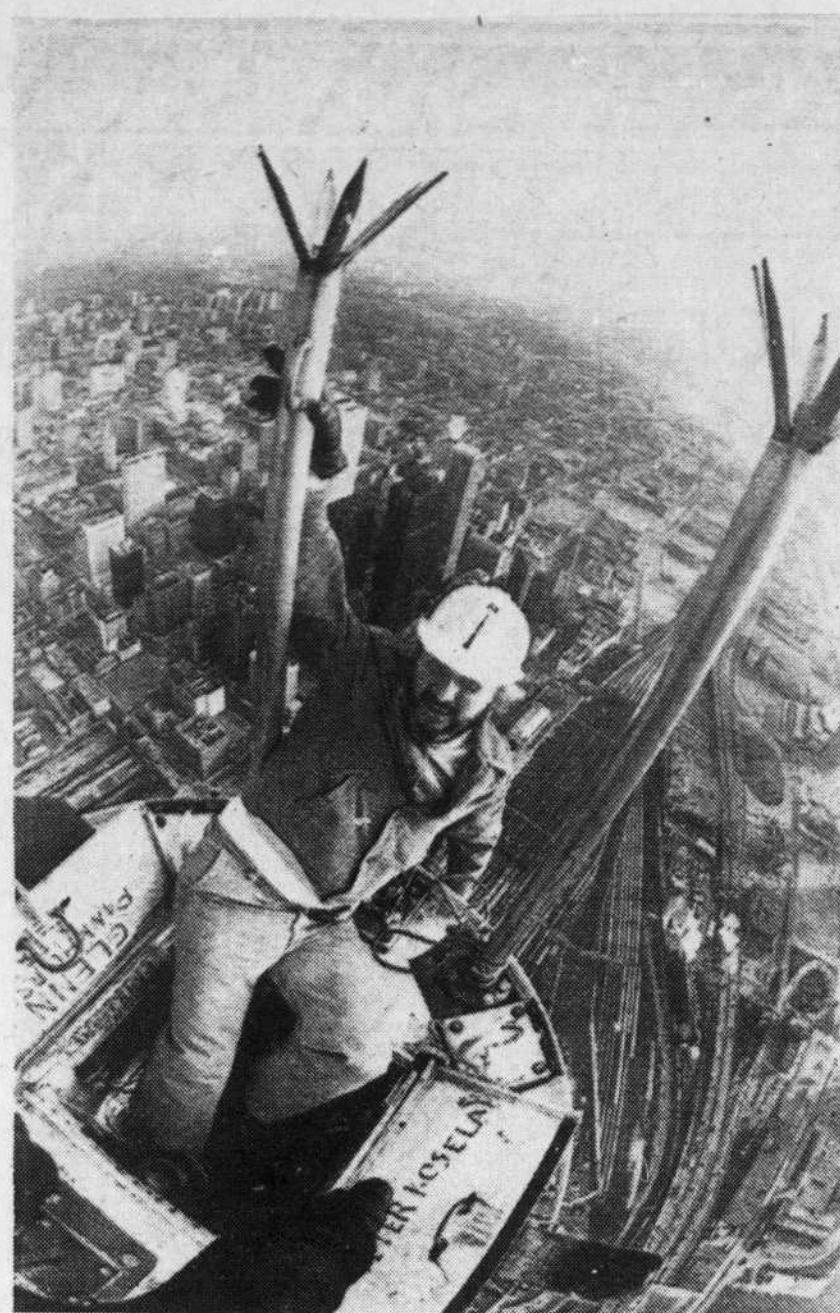
Du haut de son perchoir, cet électricien a pu contempler à satiété la ville de Toronto après avoir escaladé jusqu'à son sommet la Tour CN pour aller réparer l'antenne de l'édifice. Des panneaux protecteurs en fibre de verre pesant 200 livres chacun ont été détruits par un orage électrique. Un photographe du Toronto Star a pu croquer sur le vif ce spectacle inusité. (Téléphoto CP)
