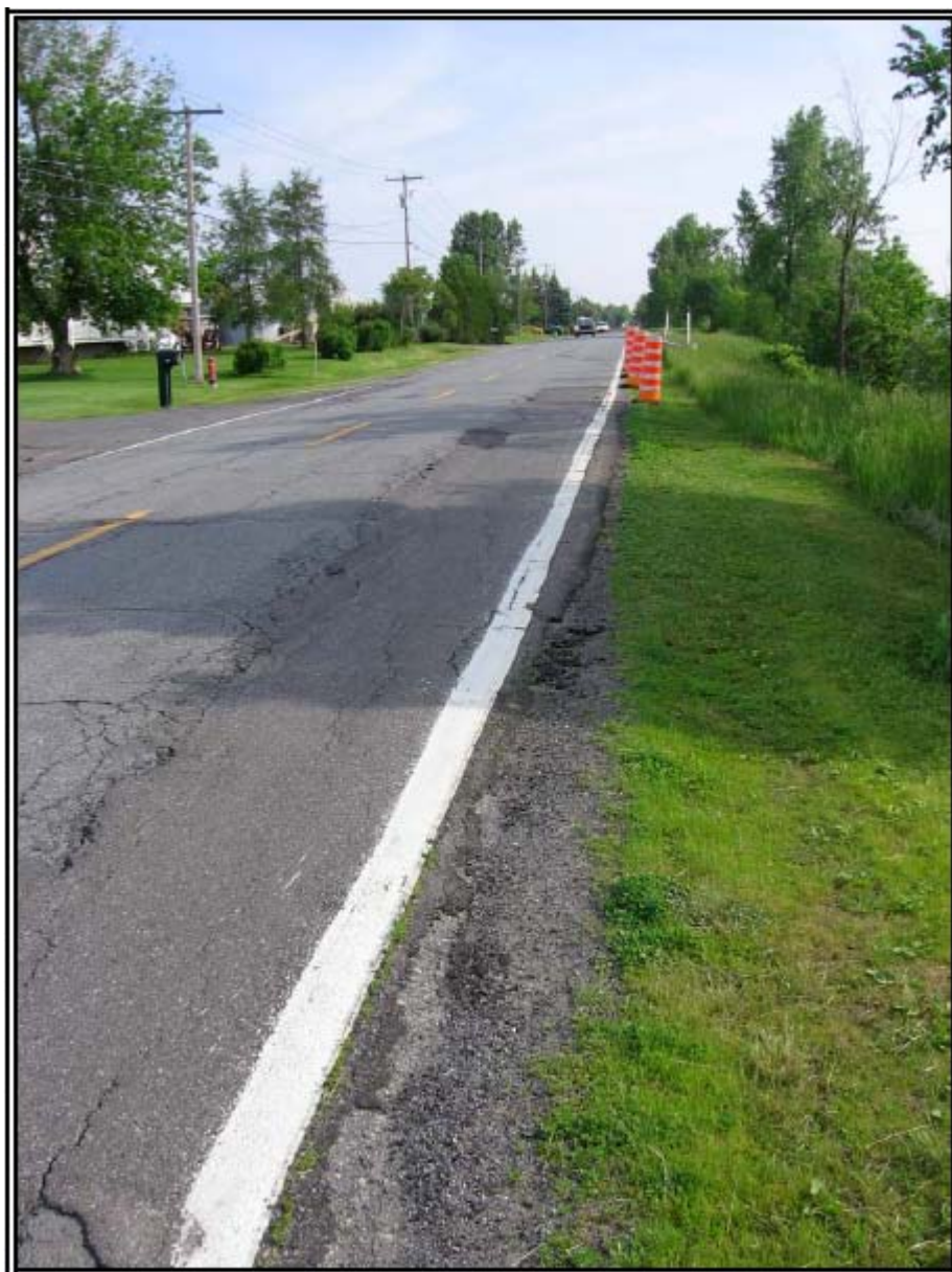
Photo 6 : Vue vers l'aval de la chaussée au site #4 et traces de travaux de pavage (Saint-Antoine-sur-Richelieu)
