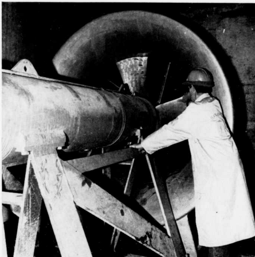
L'une des quatre pompes submersibles électriques Pleuger à la centrale génératrice de Nanticoke (Ontario Hydro).
