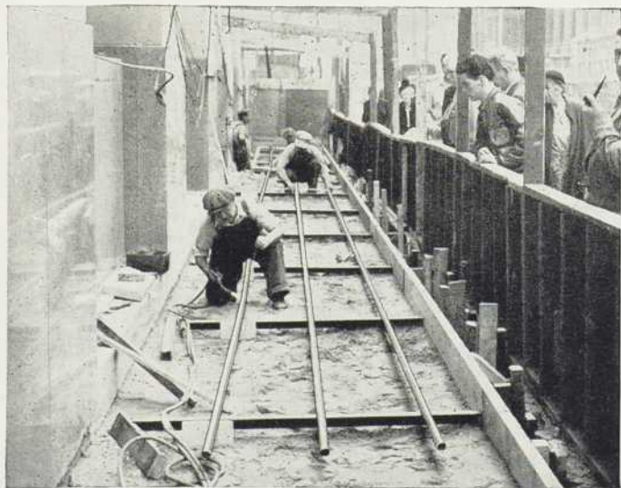
Des curieux surveillent attentivement la pose du tuyau de cuivre pour le chauffage du trottoir autour de la Banque de la Nouvelle-Ecosse.
