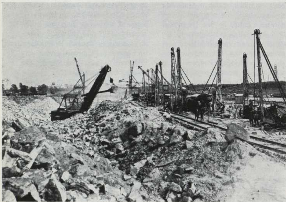
Les foreuses à l'oeuvre, perçant les trous de dynamitage. Au premier plan, la pelle électrique de 8 verges cubes. Le mât de charge mesure 90 pieds de longueur et pèse 90 tonnes.
