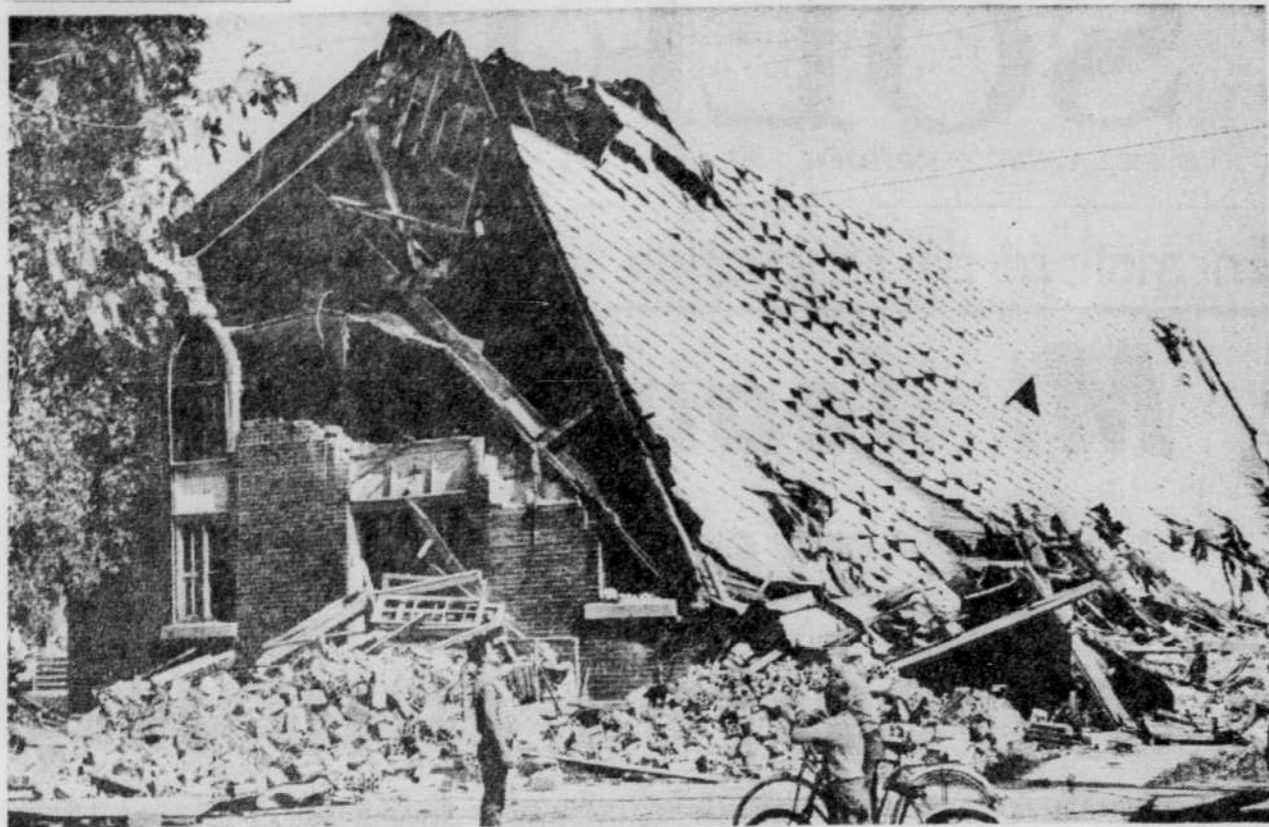
La démolition du vieux temple paroissial de Notre-Dame-de-la-Recouvrance, sur l'avenue Bélanger, à Québec-Ouest, a failli avoir des conséquences graves pour des spectateurs, samedi dernier. Les manœuvres employées n'ont pas eu le résultat prévu. Le clocher s'est d'une part effondré sur le parterre, causant la rupture d'un fil de distribution électrique. Tout un secteur de cette ville de la banlieue fut ainsi privé d'électricité pour une période plus ou moins longue. L'incident s'est produit vers 9h50 du matin. Afin de hâter les travaux, on avait installé un
