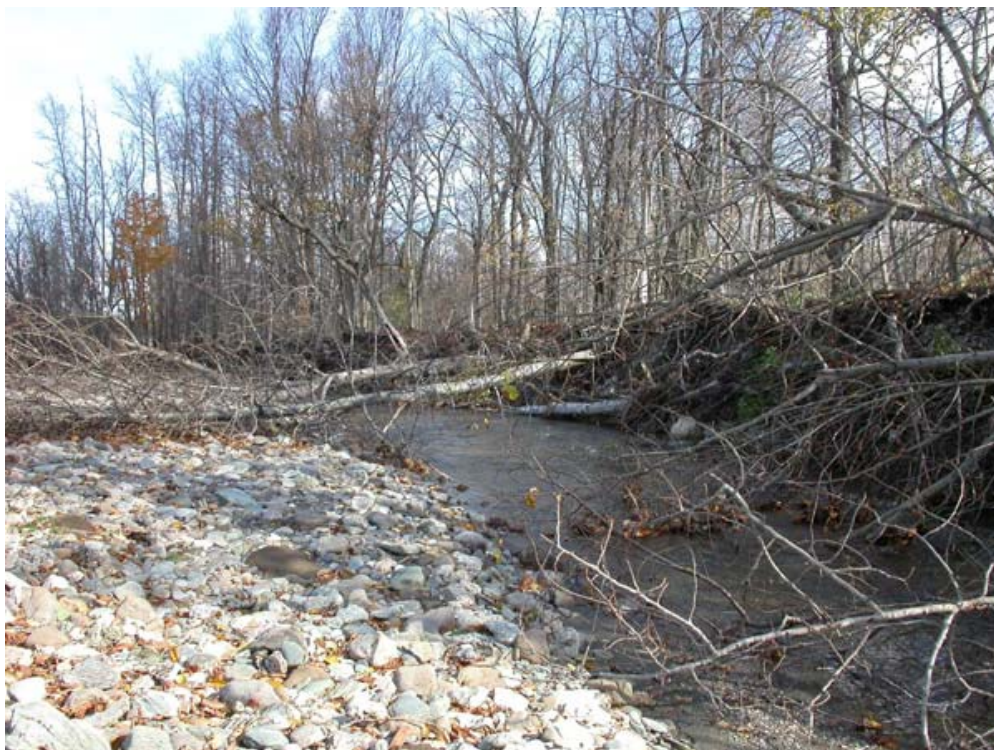
FIGURE 2. ACCUMULATION DE BANCS DE GRAVIER DANS LE LIT DE LA RIVIÈRE FORTIER ET ÉROSION DES RIVES
