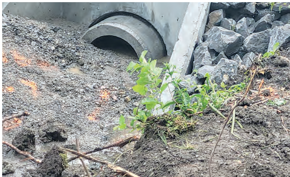
De gros cailloux qui obstruent les tuyaux. Qui en est responsable?
