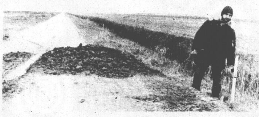
M. Yves Hamelin, technicien en travaux publics au MAPAQ, nous indique ici à quel hauteur le chemin de la Baie des ouines doit être rehaussé sur une certaine distance, à partir de l'intersection du rang Petite-Rivière.
