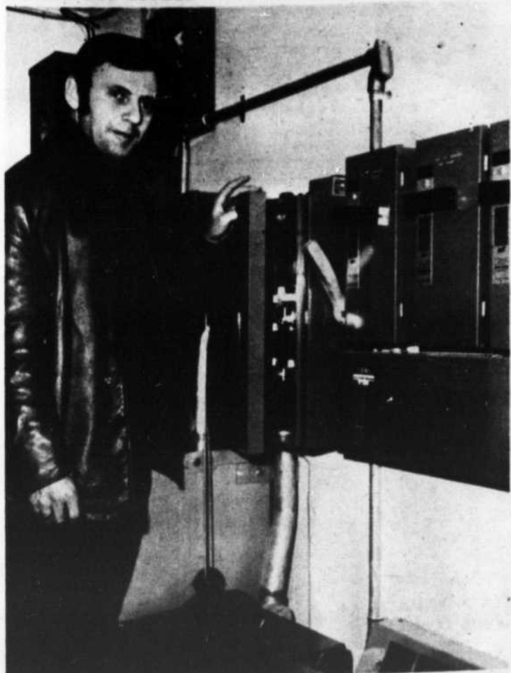
L'électricien Martin Boisvert nous fait voir le système électrique.
