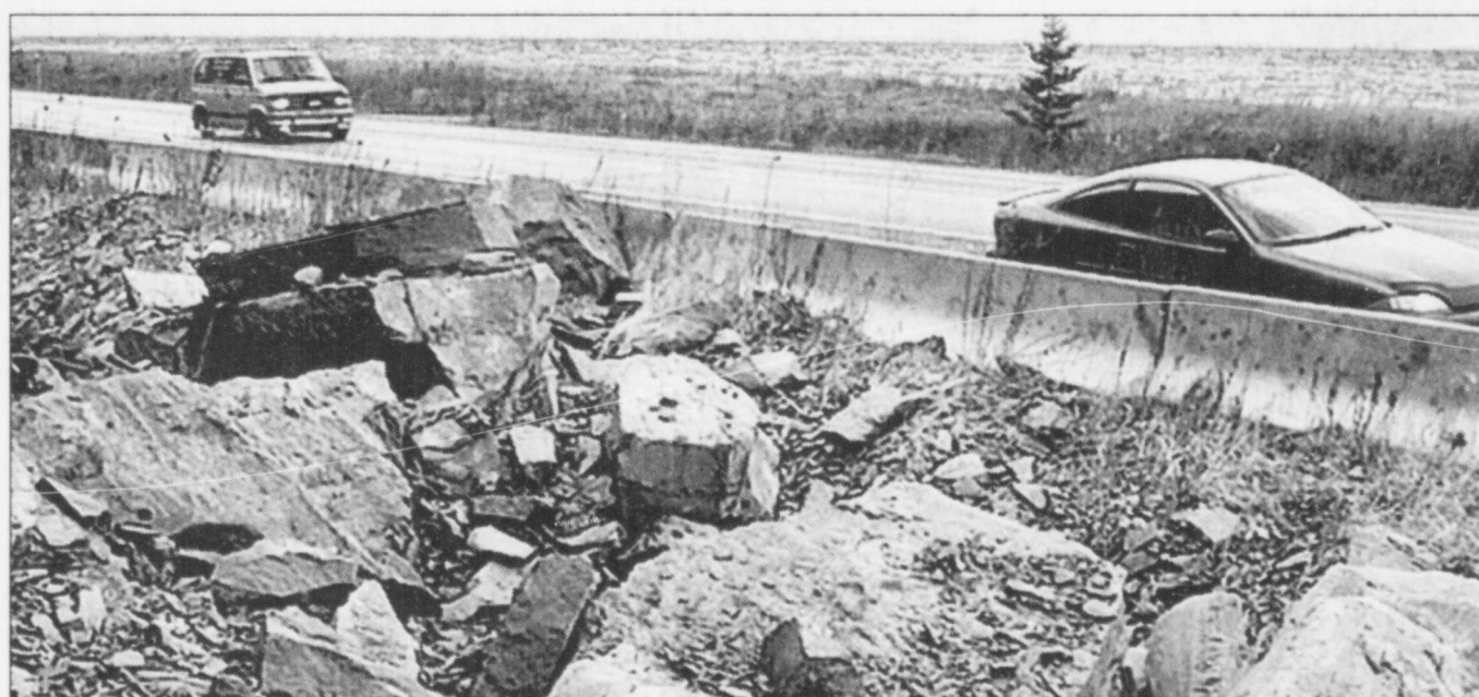
Chutes de pierres et éboulis sont fréquents entre Tourelle et Manche-d'Épée, ci-dessus, sur la rive nord de la péninsule.
