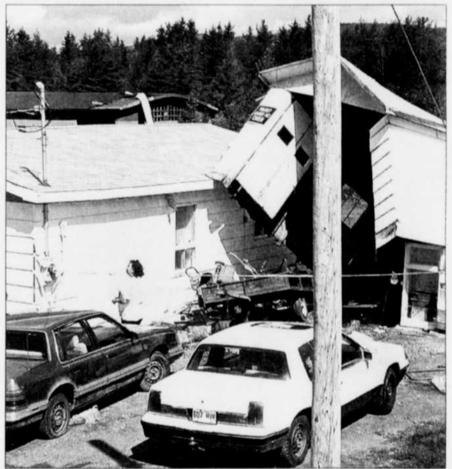
À Falardeau, un garage a été soufflé sur une maison.
