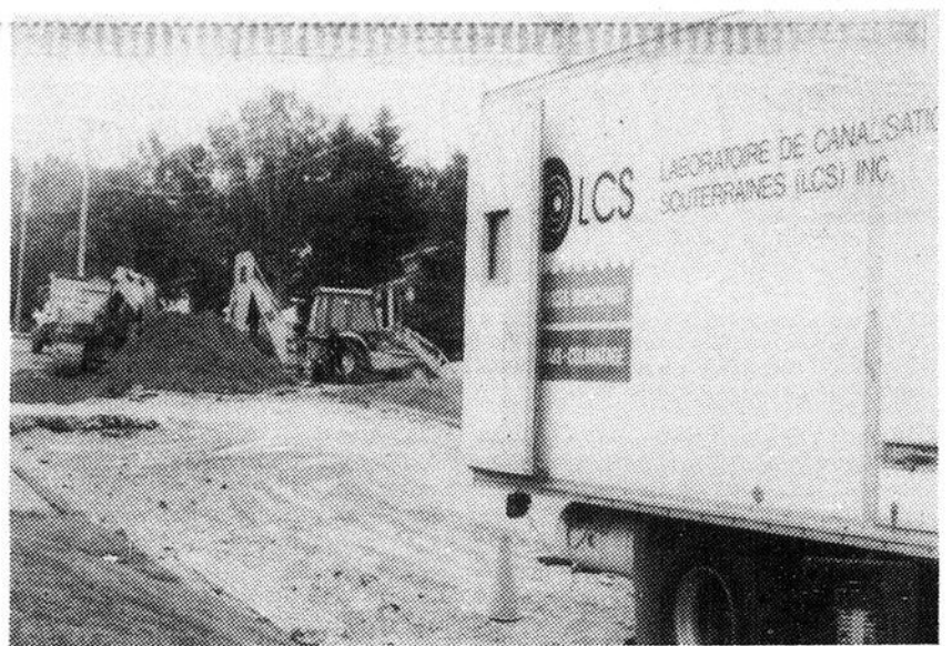
Les travaux de réparation qualifiés d'urgent ont débuté la semaine dernière et sont financés avec des sommes appropriées des surplus accumulés.
