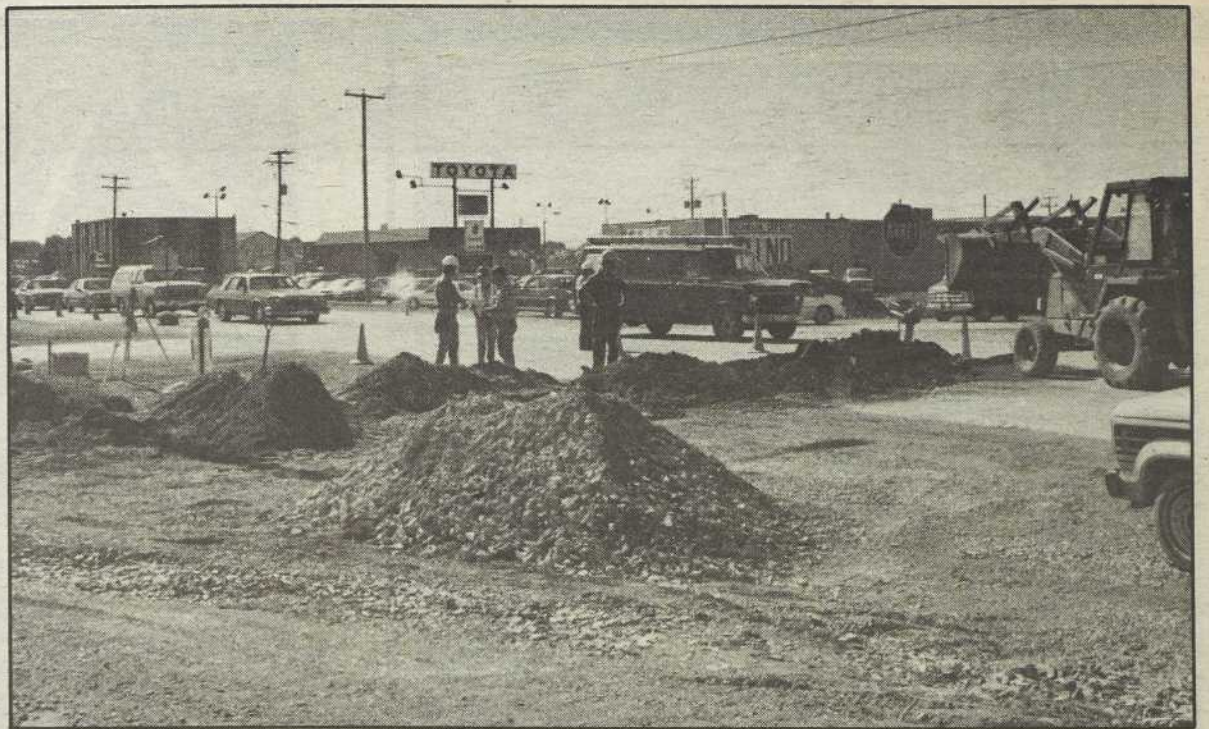
Des travaux de réfection de la chaussée ont lieu présentement sur la route 112, notamment à la hauteur du boulevard Bouchard (ci-contre). photo Alain Dion
