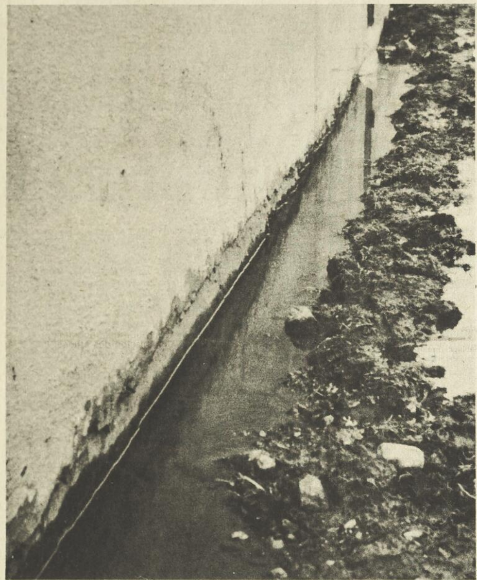
Des dalles de béton directement coulées sur le sol, des murs déposés par-dessus, un quart (ou un huitième?) de pouce de stucco pour "habiller" le tout, un système d'égouttement du sol qui brille par son absence: cette construction a été jugée acceptable par les inspecteurs de la Société Centrale d'Hypothèques et de Logements, qui avec les fonds publics a avancé $826,000 à Grand Prix Construction.
