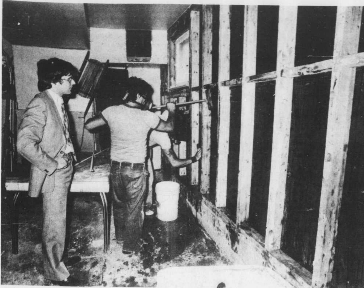
Après avoir fait ouvrir les murs de sa maison de Saint-Lambert pour en extraire toute la mousse d'urée-formol, M. Jean Mailloux observe les deux ouvriers qui badigeonnent la structure de bisulfite de sodium pour neutraliser toute la formaldéhyde qui aurait pu s'y imberber. Il reste encore de la mousse à l'extérieur du mur, juste derrière la brique. (Photo Réjean Meloche)
