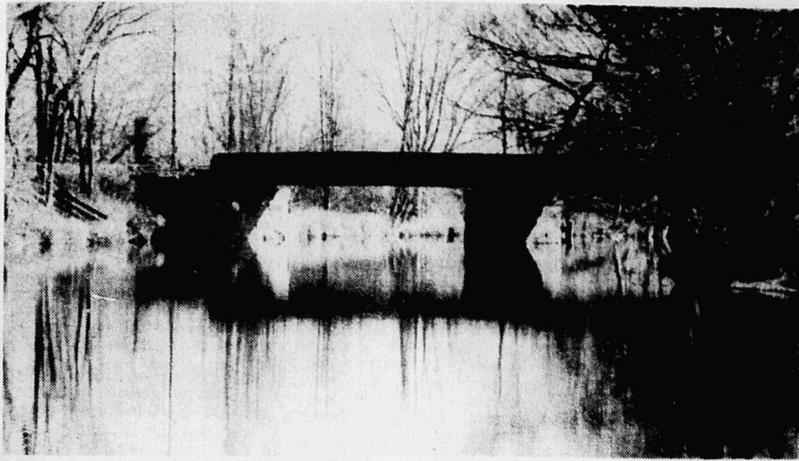
C'est ce pont qui appartenait auparavant à la compagnie ferroviaire Conrail des Etats-Unis que le ministère des Transports a acquis pour faire la reconstruction du pont Murray entre Elgin et Godmanchester.
