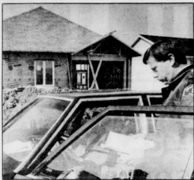
Un policier dresse un constat de l'explosion qui a causé de graves blessures à deux électriciens dans une maison en construction.
