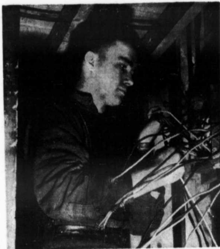
Ce jeune apprenti se retrouvera facilement dans le fouillis de fils électriques entrant dans une maison.
