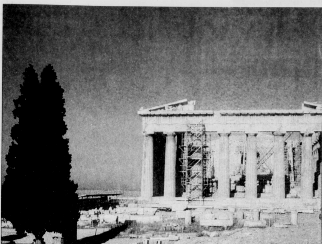
Des travaux dans le cadre du programme global de restauration de l'Acropole. ARCHIVES LE SOLEIL
