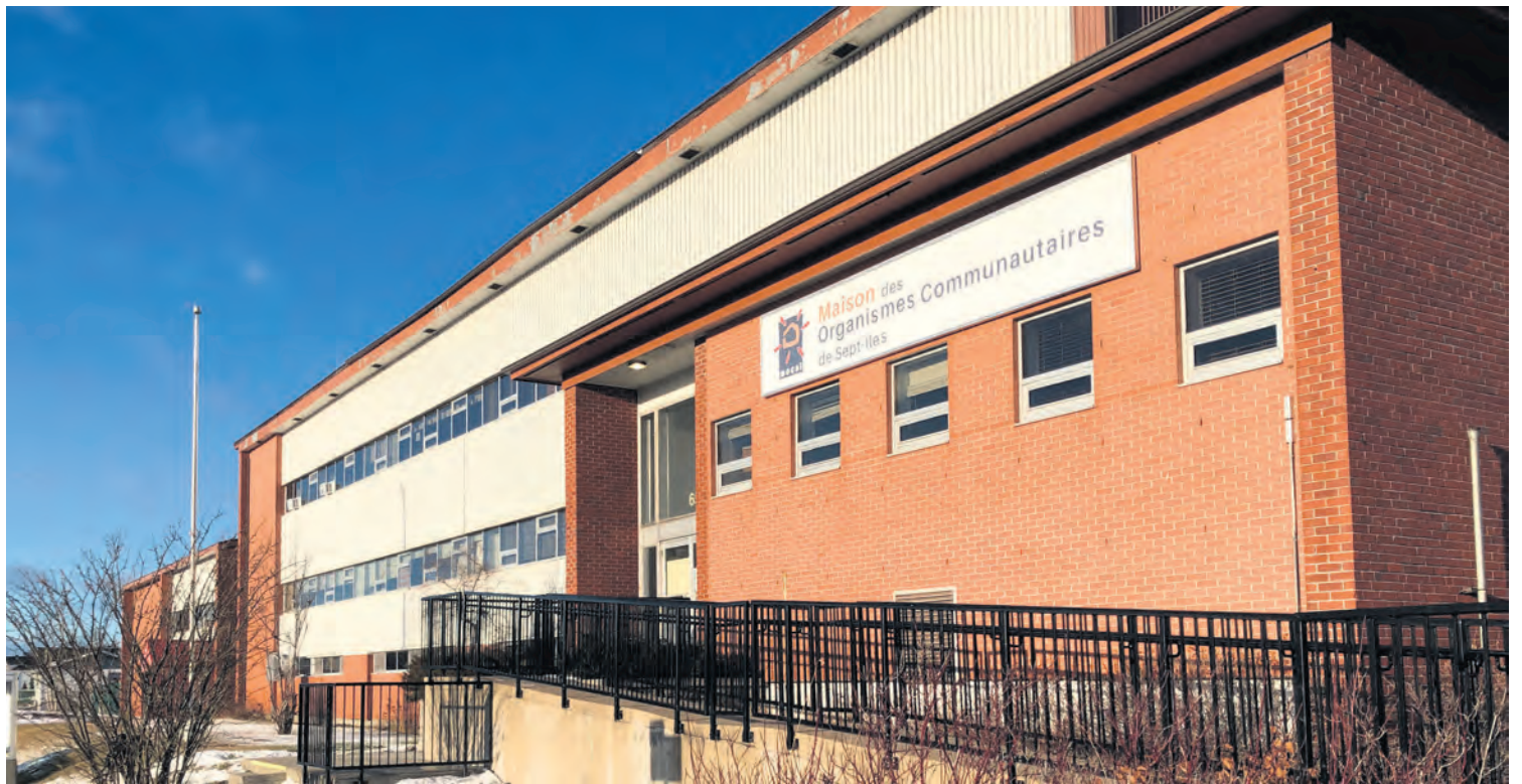
D'importants travaux seront réalisés en 2022 à la Maison des organismes communautaires de Sept-Îles, notamment au niveau de sa toiture.
