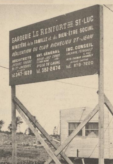
LES TRAVAUX d'excavation du futur centre d'hébergement "Le Renfort", pour les enfants-problèmes, se poursuivent à St-Luc. Ce centre d'hébergement, qui pourra accueillir plus de 150 enfants déficients mentaux, coûtera plus de $1,500,000, au ministère de la Santé du Québec. C'est grâce à une initiative du Club Richelieu de St-Jean que cette oeuvre humanitaire a pu être réalisée. (Photo Studio Brouillette)
