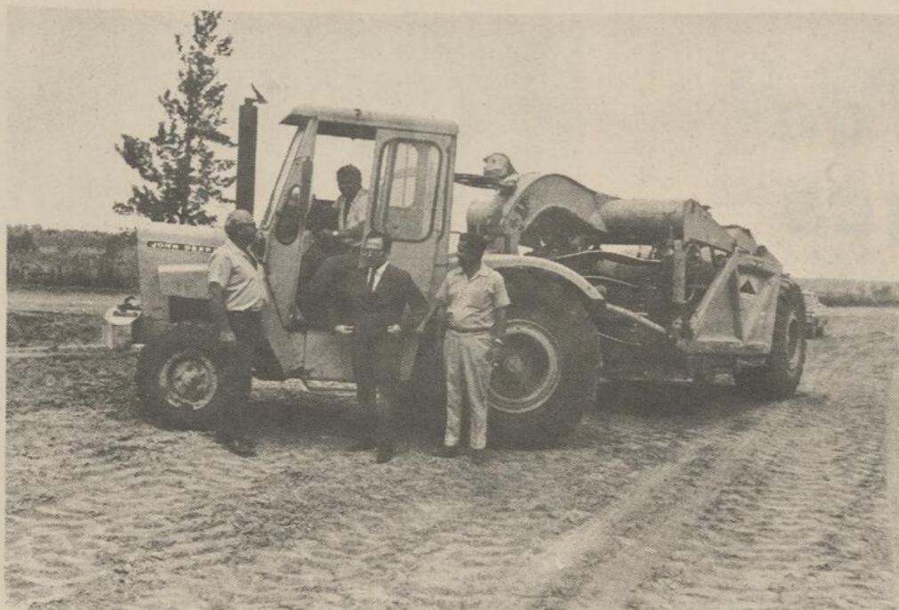
RANG SALVAI. - D'importants travaux de voirie s'effectuent présentement dans le rang Salvail, dans la municipalité de St-Jude. Ils consistent en l'élargissement et la reconstruction du chemin. Des travaux similaires s'effectuent aussi dans la partie du même rang comprise dans la municipalité de La Présentation. Il s'agit de faire un nouveau chemin qui deviendra régional. Notre photo fut prise sur les lieux du chantier, où nous apercevons, de gauche à droite, M. Charles Boulay, de la voirie, M. Maurice Guillette, opérateur de la machine, M. Denis Bousquet, député provincial du comté de Saint-Hyacinthe, et M. Réal Armstrong, ingénieur de la voirie. (Photo Bernard St-Pierre)
