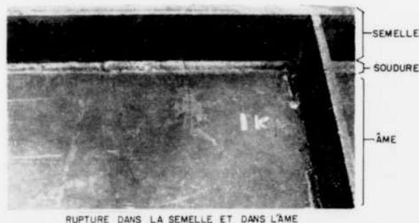
Fig. 10 : Fissure en fatigue d'une poutre soudée en acier calmé.
