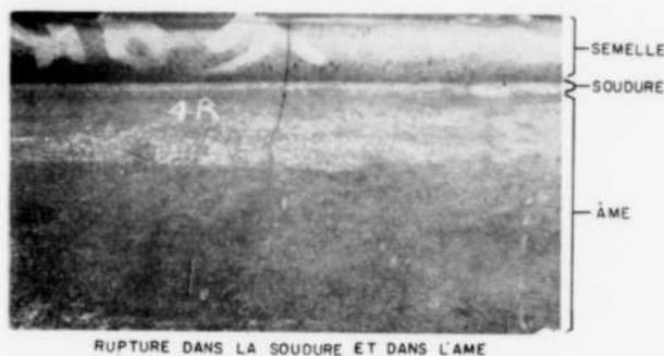
Fig. 9 : Fissure en fatigue d'une poutre soudée en acier effervescent.
