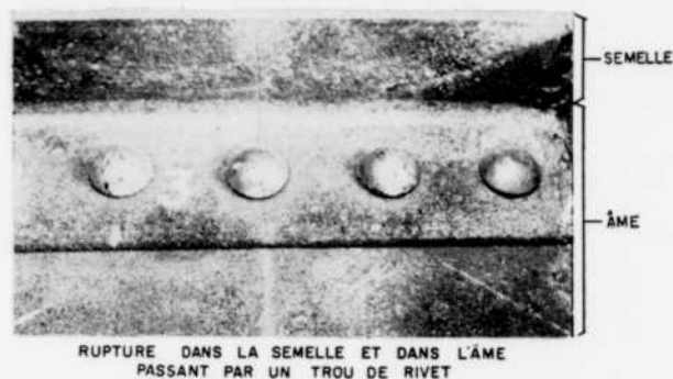
Fig. 12 : Fissure en fatigue d'une poutre rivetée.
