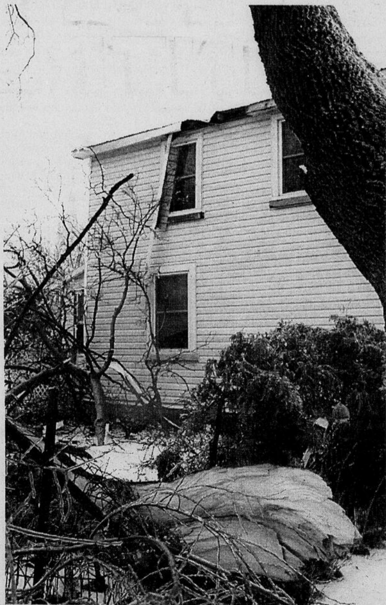
Plusieurs toits de maisons ont été endommagés par les chutes d'arbres ou de branches chargés de verglas.
