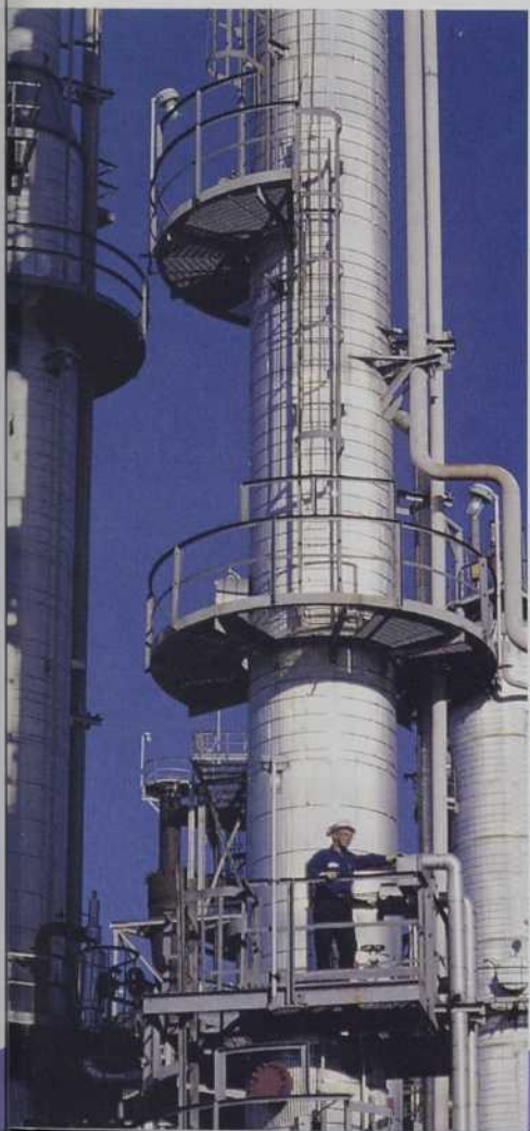
Tours à fractionnement de la raffinerie Shell.
