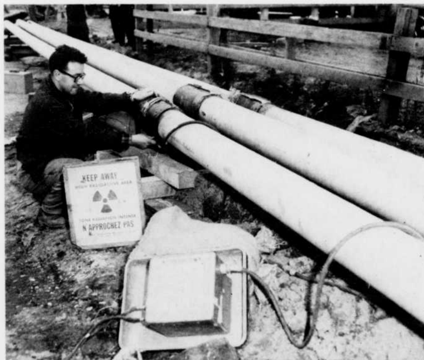
4 — On procède à la photographie par rayons Gamma de chacune des soudures afin de s'assurer qu'elles sont sans défaut.
