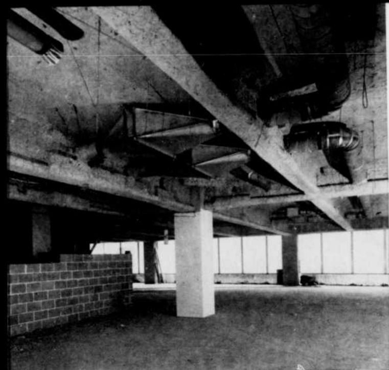
Les conduites de climatisation passent à travers les poutres d'acier.
