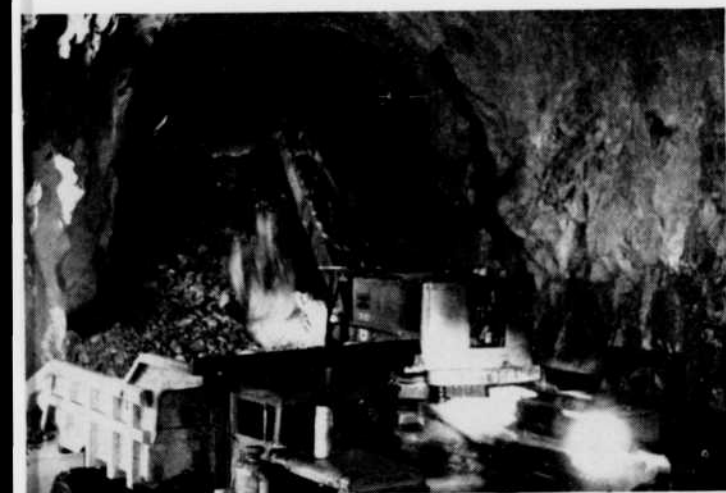
Intérieur d'un des deux tunnels de 2,200' de longueur sur 47' de diamètre, construits pour détourner la rivière Manicouagan du barrage principal durant la construction. Le sautage périmétrique au XACTEX a permis d'obtenir des parois lisses et uniformes pour les murs et la voûte du tunnel.
