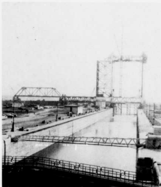
Installation électrique et éclairage. Ecluse de St-Lambert — Canalisation du St-Laurent
