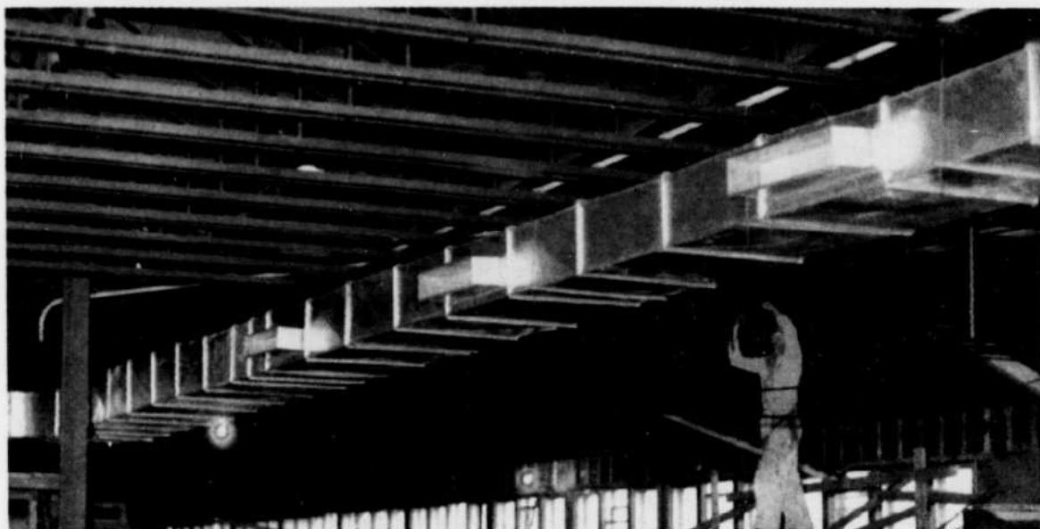
Vue partielle d'un système de ventilation au laboratoire de Physique et Chimie de l'Université d'Ottawa faite par
