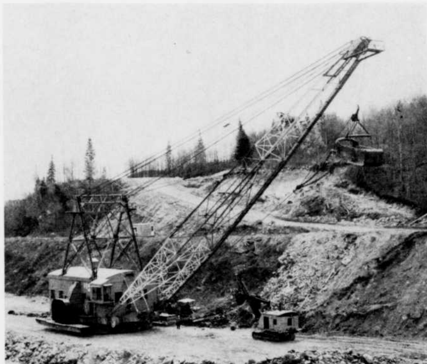
Fig. 5 — Cette énorme grue, dont le mât de charge atteint la hauteur d'un édifice de dix étages, sert au creusage du lit de la rivière en aval du barrage
