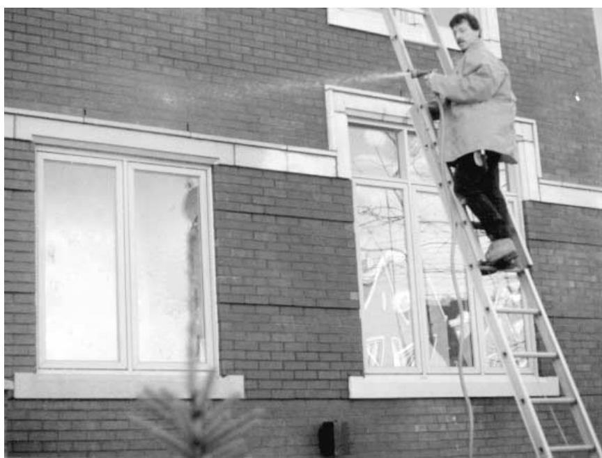
Il faut souvent exécuter un test d'arrosage pour prouver la source d'une infiltration d'eau et déterminer la cause du problème.
