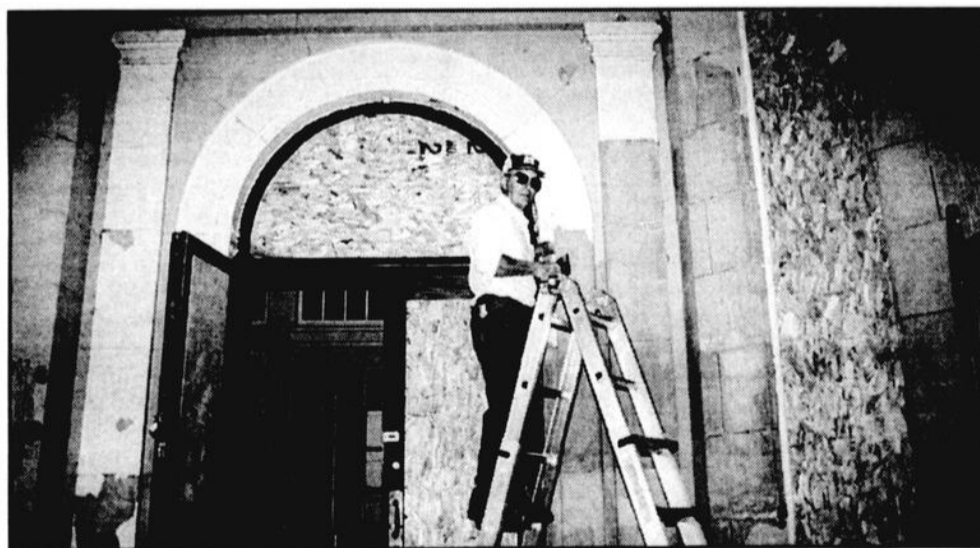
L'incendie survient moins d'une semaine après le début des travaux de restauration de l'édifice. Cette photo a été prise mercredi dernier alors qu'un maçon s'affairait à refaire la façade du bâtiment. (Photo : H.T.)
