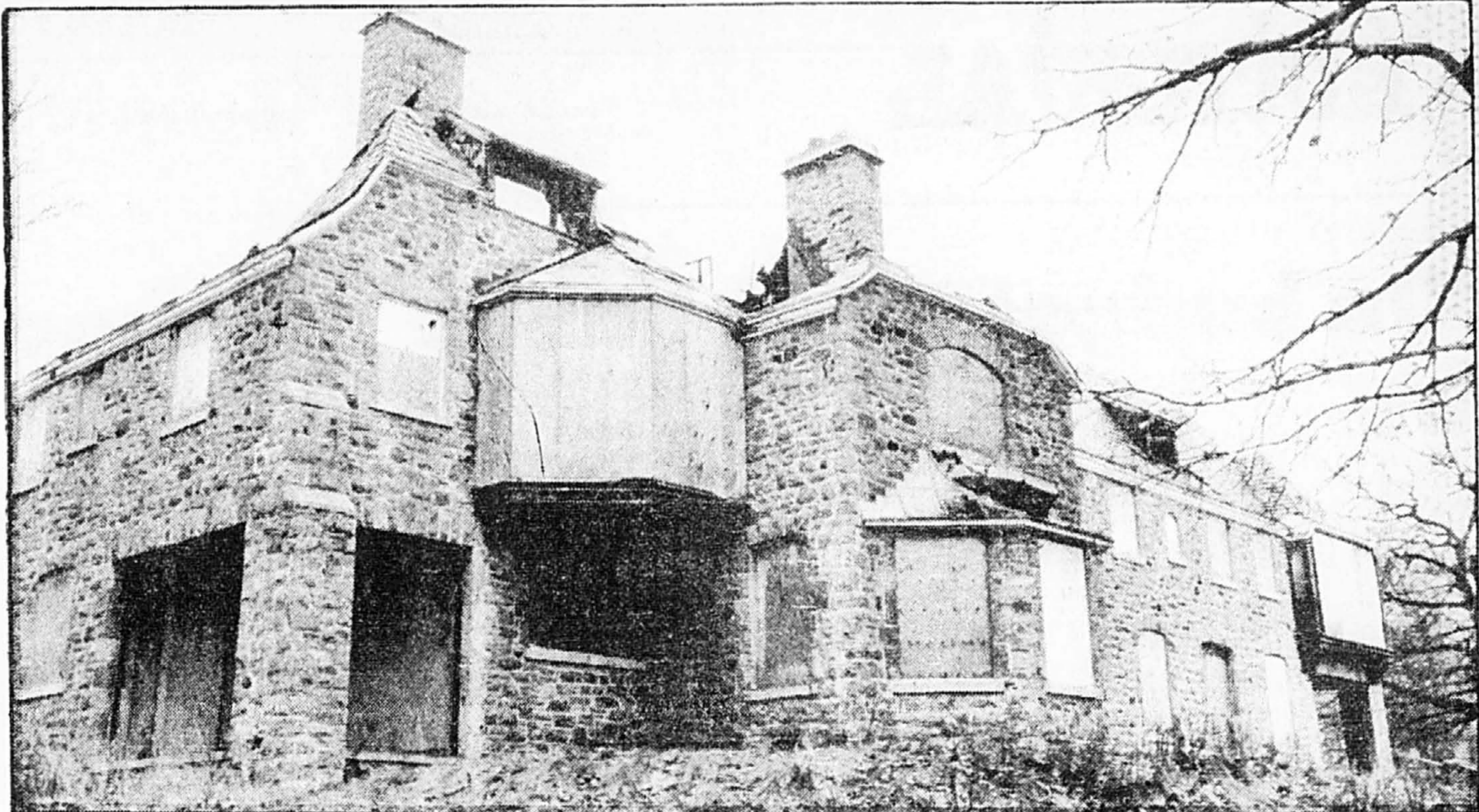
Le manoir Ogylvie avait été déclaré monument à conserver par la Commission d'arbitrage du patrimoine résidentiel de la ville de Montréal en août 1979. Depuis ce temps l'immeuble a
