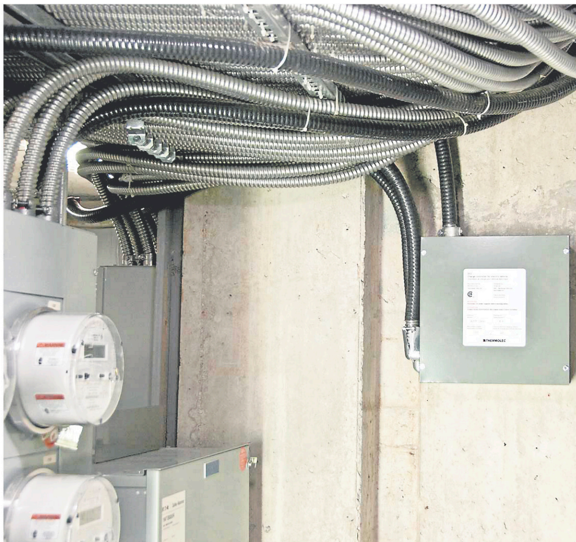
DCC Condo est un dispositif qui peut être installé entre le compteur du condo du copropriétaire électromobiliste et son panneau électrique. Il sert de disjoncteur et gère l'énergie. — PHOTO FOURNIE PAR RECHARGE VÉHICULE ÉLECTRIQUE
