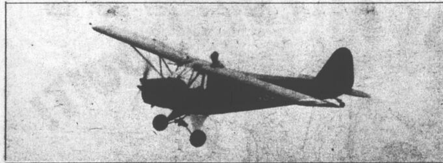
Le "fermier volant", pilote acrobatique américain, a soulevé l'assistance par ses prouesses aériennes. Si vous remarquez bien sur la photo, on le voit juché entre les deux ailes.
