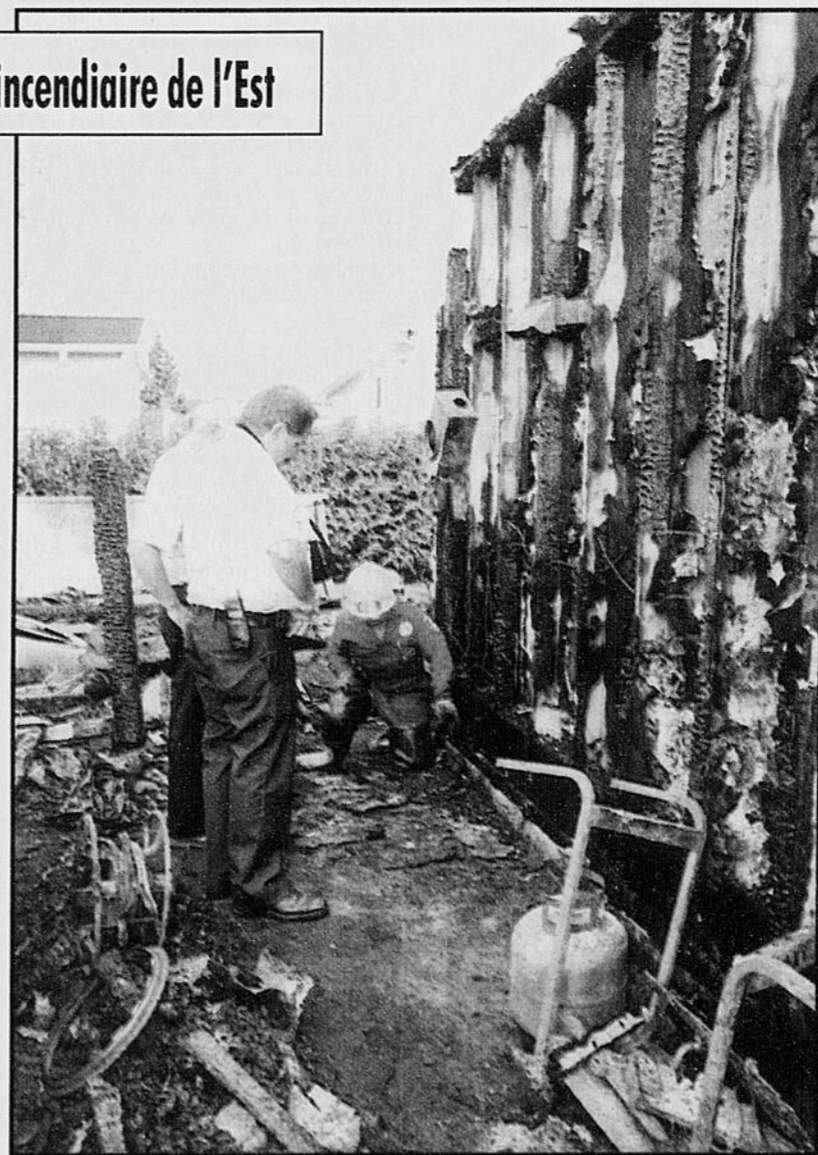
L'inspecteur Bernard Brisson, du Département de prévention des incendies de même que le détective Jean Perreault et le technicien Michel Martin, de la Police municipale de Sherbrooke, ont procédé à un nouvel examen des lieux, 1010 rue Baron, à Fleurimont, hier matin. Conclusion: incendie d'origine criminelle.
