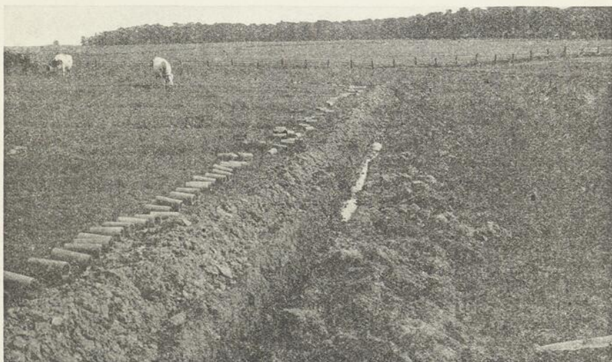
Le drainage souterrain est souvent très utile.
