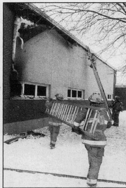
Les dommages causés au gymnase de l'école étaient très visibles à l'extérieur.
