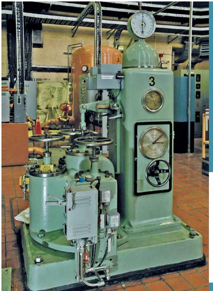
Régulateur de vitesse associé au groupe turbine-alternateur n° 3 de la centrale des Rapides-Farmer, mis en service en 1929. Cet équipement est aujourd'hui recensé dans la Collection historique d'Hydro-Québec et préservé à son emplacement d'origine à des fins d'interprétation.
