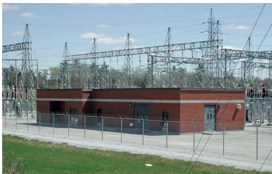
Nouveau bâtiment de commande du poste blindé bâti à la fin des années 1990, en remplacement de son prédécesseur obsolète. Son esthétique sobre aux volumes simples ainsi que le choix de matériaux de construction semblables à ceux de l'ancien poste facilitent son intégration au paysage de la centrale.
