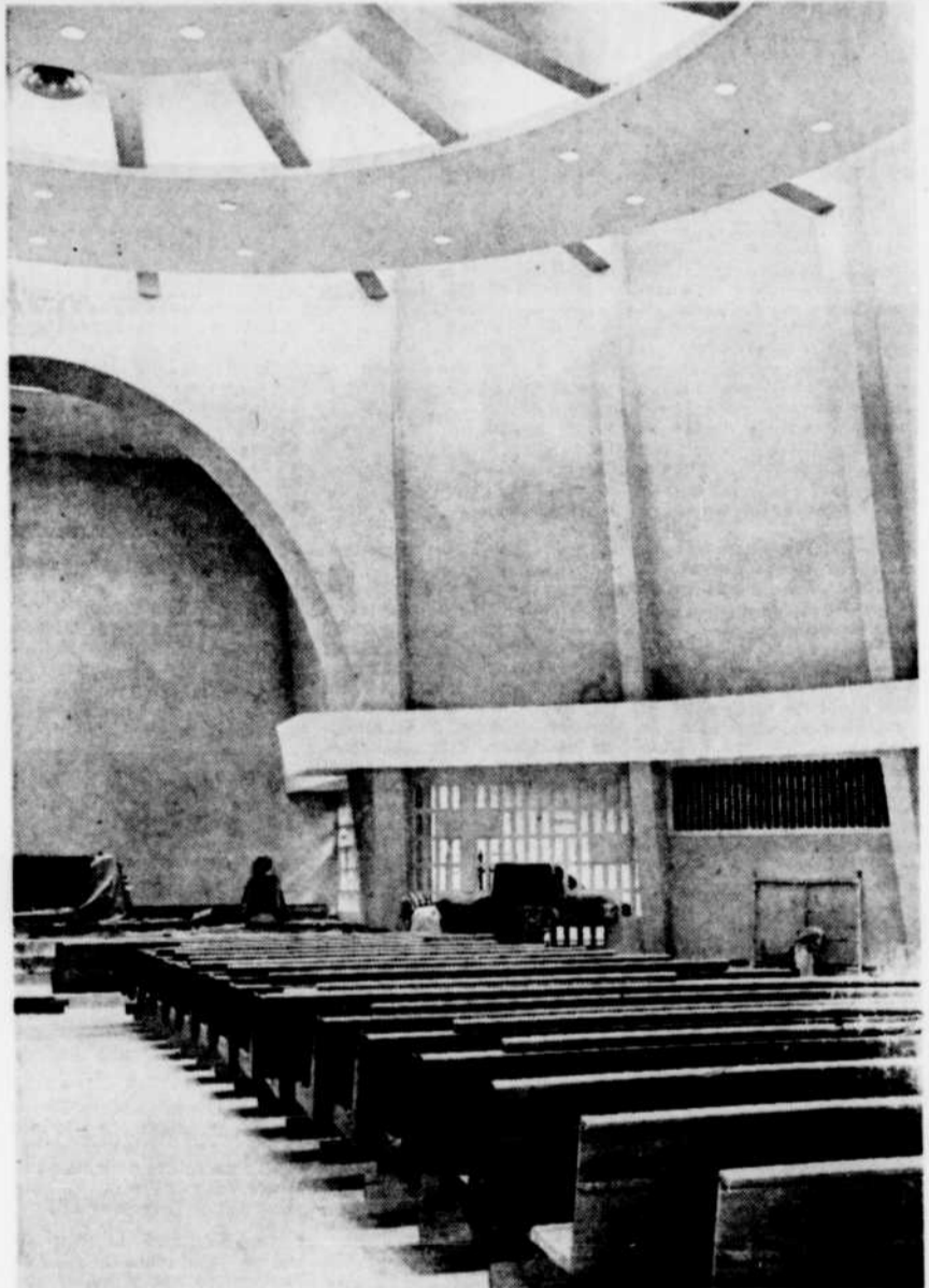
EGLISE ST-PIE X — Les travaux progressent à l'intérieur de l'église St-Pie X, mais il sera impossible d'y célébrer la première messe, dimanche prochain, comme on l'avait d'abord anticipé. Les paroissiens peuvent toutefois espérer entrer en possession de leur église, à la fin du mois de mars, soit le 28. Ci-dessus, une vue intérieure de l'église et un aspect général des travaux d'aménagement. (Photo La Tribune)
