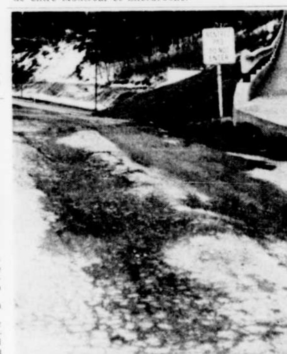
CA "CRAQUE" — La voie d'accès conduisant à la route 5-22, direction Bromptonville, a été victime des intempéries de la nature. On peut dire que ce tronçon de route est mi-macadam, mi-asphalte.
