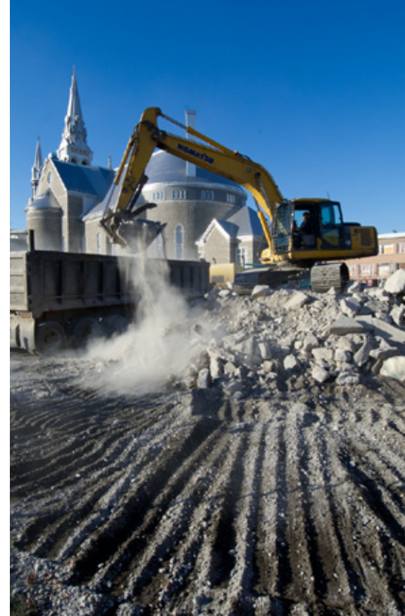
Au cours de l'été on aménagera une place publique derrière la Cathédrale suite à la démolition du centre diocésain effectué l'an dernier (notre photo)
