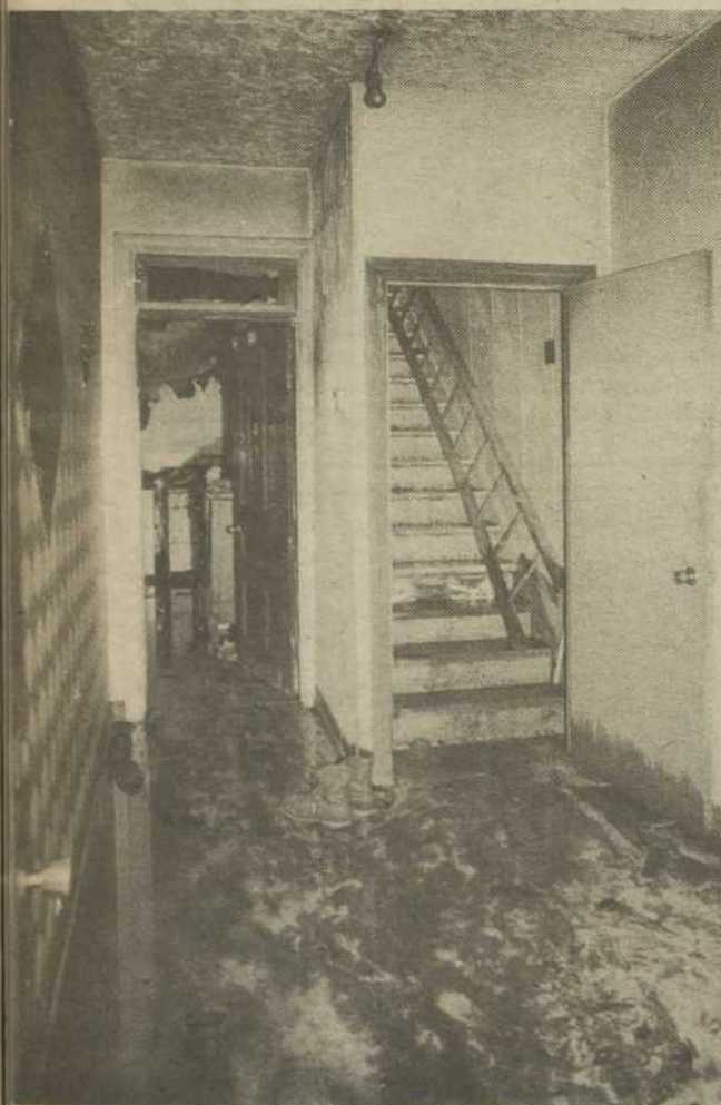
Le hall d'entrée a été durement affecté par l'eau et la fumée.
