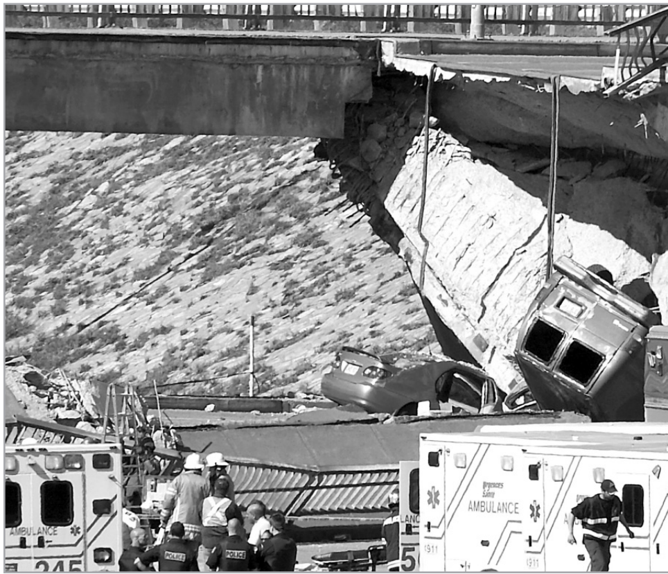
Les causes de l'effondrement du viaduc de la Concorde, à Laval, le 30 septembre 2006, intéresse non seulement les ingénieurs québécois, mais aussi ceux d'à travers le monde.
