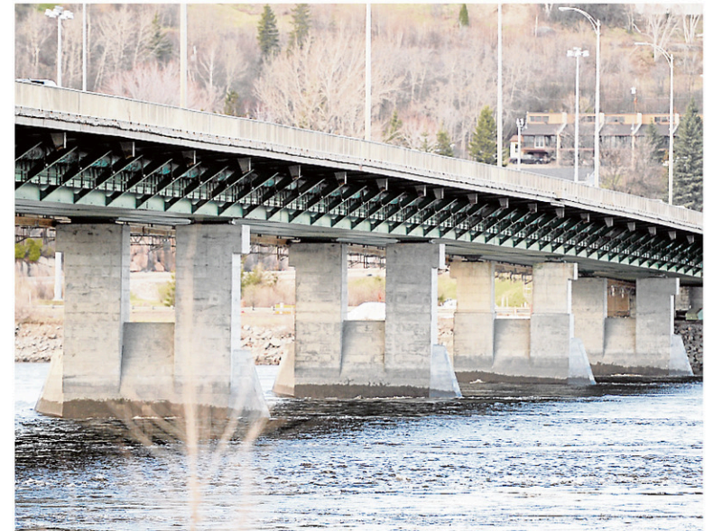
La circulation est interdite sur le pont Dubuc aux véhicules de plus de 12 tonnes en raison de la corrosion sur les poutres-caissons. — PHOTO LE QUOTIDIEN, JEANNOT LÉVESQUE
