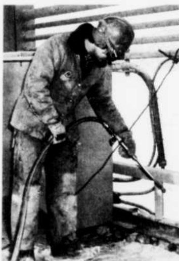
Ce garde protecteur, dont Roger Gilbert procède à l'installation finale, marque un pas de plus dans la voie de la sécurité au port.
