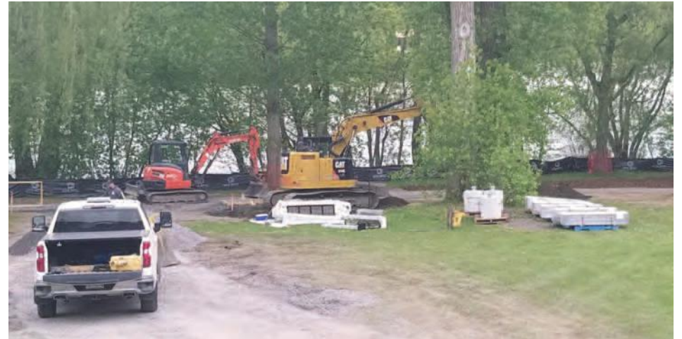
Les travaux de réaménagement en cours au parc des Rapides de Chambly. (Photo : Chloé-Anne Touma)
