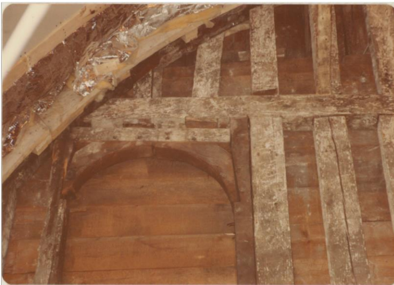
Gros plan de la partie haute de l'ancienne ouverture, côté sud, située sous le tableau de Saint François de Sales , 6 décembre 1982, Québec, Le Monastère des Augustines, HG-A-26 (Restauration de l'église, no. 402). (voir le rapport de Patrick QUIRION, p. 23)
